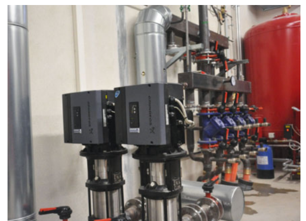
Die beiden Pumpen (im Vordergrund) im Heizungsraum der Nahwärme Dürrenzimmern wechseln sich im Betrieb ab.
