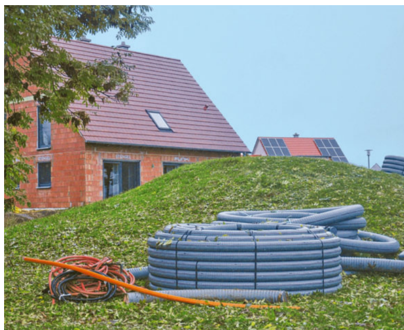
Während der Bauphase Anfang Oktober sah es in Dürrenzimmern so aus. Im Vordergrund die Wärmeleitungen aus Kunststoff.
